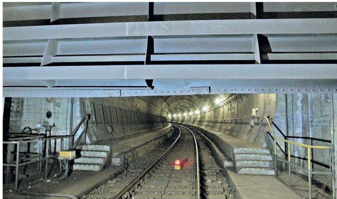
Falls die Isar je die Decke des Stammstrecken-Tunnels durchbricht, sollen zwei je 25 Tonnen schwere Wasserschutzore die S- und U-Bahn schützen.
